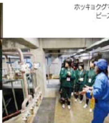
園内の汚水処理施設
